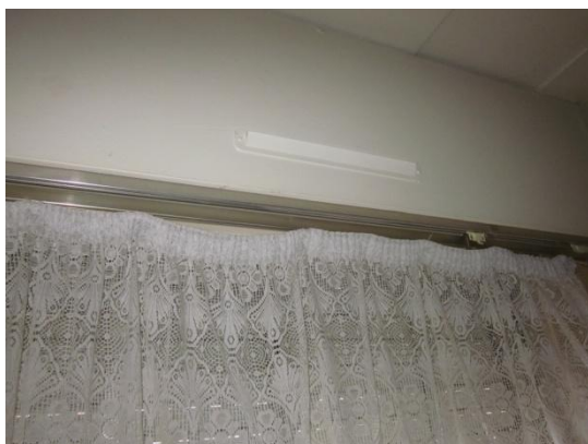
Entrée d'air sur les coffres de volet roulant
