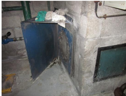
Ventilation basse de la chaufferie
