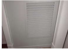
Grille de ventilation basse des parties communes
