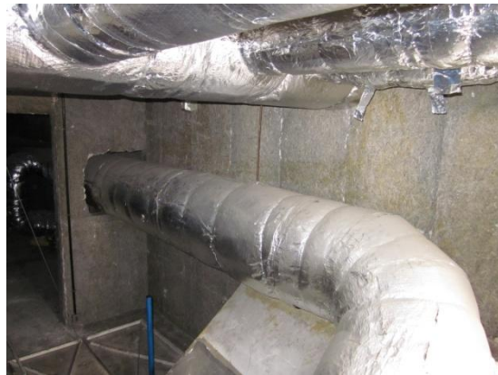
Réseau de ventilation calorifugé
