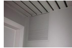
Grille de ventilation haute des parties communes
