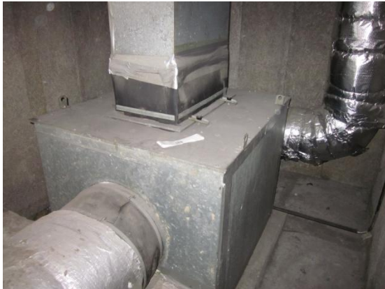
Caisson d'extraction du bâtiment 32
